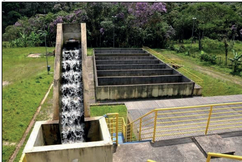
Figura 49 – Estação de Tratamento de Esgoto – Parque Andreense
